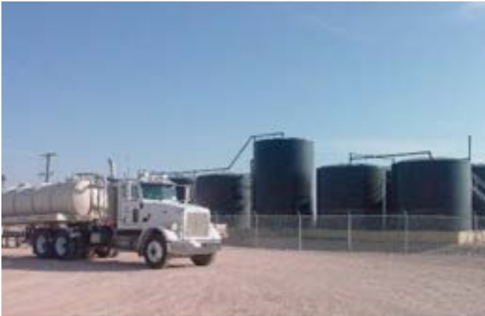
Descarga de camiones en batería de producción para separación de crudo/agua y almacenamiento
